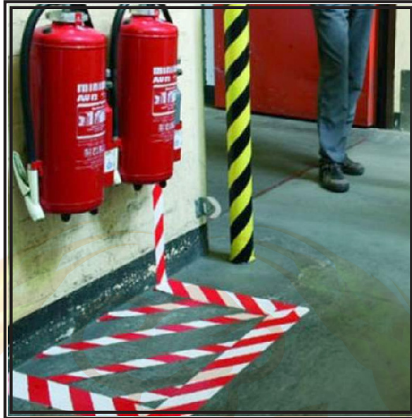
تصویر ۸-۱ مثال دو، علامت گذاری روی سطوح (استانداردسازی). محدوده قرار گرفتن کپسول های اطفاء حریق با نوار قرمز-سفید مشخص شده است.
